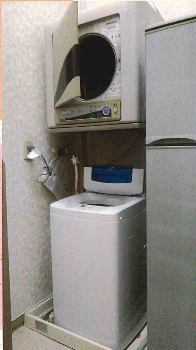
洗濯機・乾燥機
